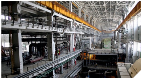
Тюменская ТЭЦ-1, филиал ОАО «Фортум» Разработка проекта по оснащению дымовых труб автоматизированной системой измерения выбросов загрязняющих веществ в атмосферу.
