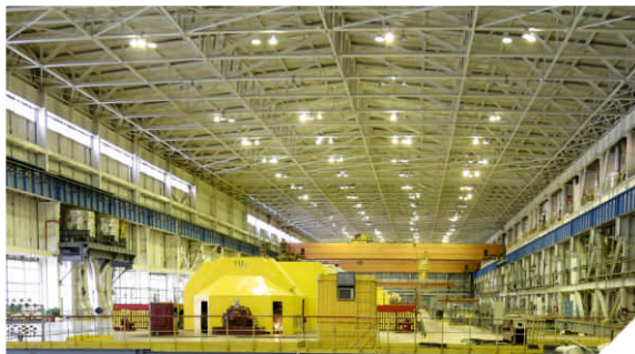
Пермская ГРЭС, филиал АО «ИНТЕР РАО-Электрогенерация» ТО и Р КИПиА трех энергоблоков 800 МВт, обслуживание с 2009 г., 49 человек.
